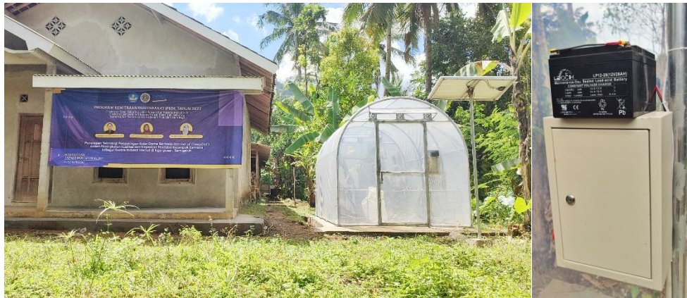
Gambar 3. Pemasangan solar dryer dome dan panel box di Dusun Ngargosari
